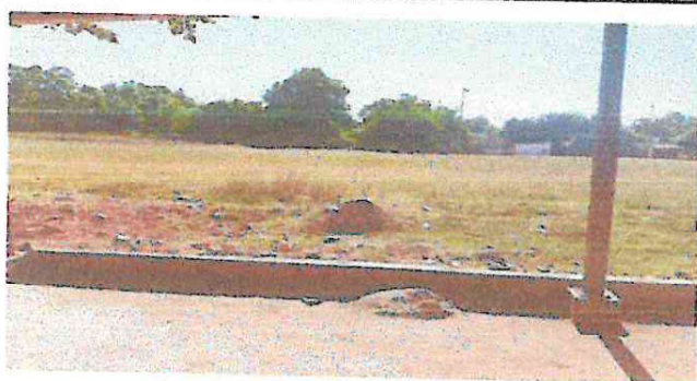
Foto 1: No está completo el muro perimetral, se necesita completar una parte con malla, block y tubo y otra solo con block.
