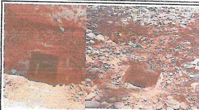
Foto 2: Falta la tapadera de una caja y reparación de la otra
