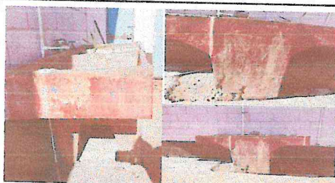
Foto 3: La pila está quebrada y solo está sobrepuesta.
